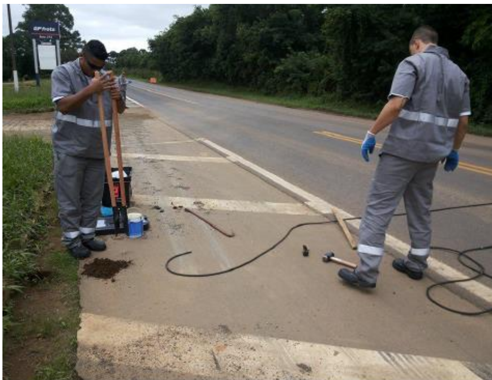
Figura 6 – Processo de instalação do equipamento para contagem volumétrica mecanizada.
