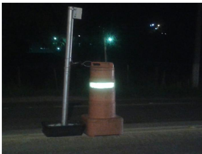
Figura 5 – Radar Instalado (PELC-RJ 2045).
